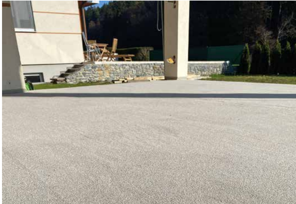
Zum Schluss wurde die noch feuchte Oberfläche mit Quarzsand abgestreut. Somit ist die Terrasse für die Installation eines festen Fremdbelags vorbereitet. | Fotos: © Triflex (5)
